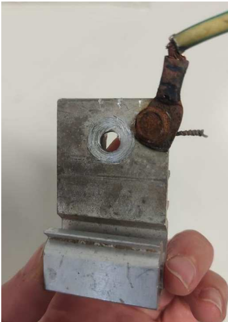
Grapa con terminal de tierra atornillado oxidado
