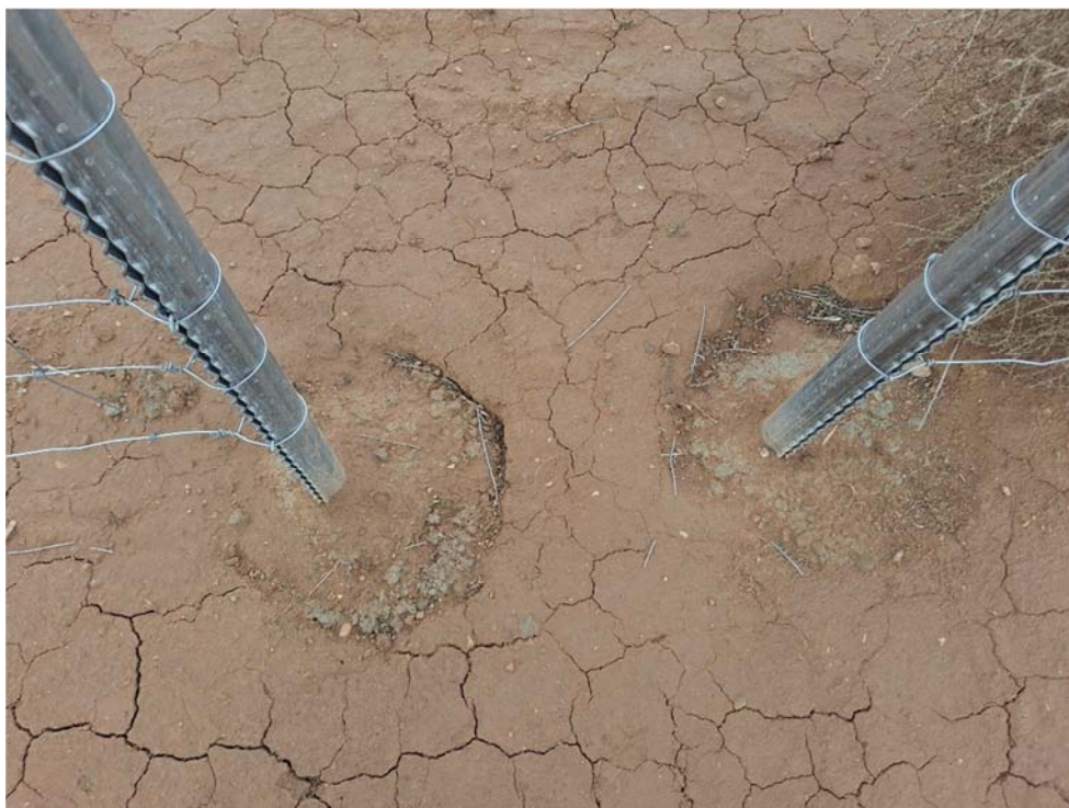
Figura 8.6. Restos de alambres localizados en el suelo junto a los pasos de fauna, observados a fecha 15-01-24
