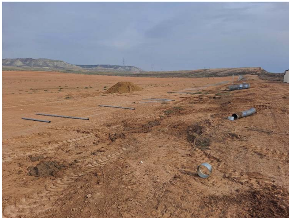
Figura 8.4. Trabajos de reposición del vallado deteriorado, a fecha 15-02-24. Límite sureste de la parcela
