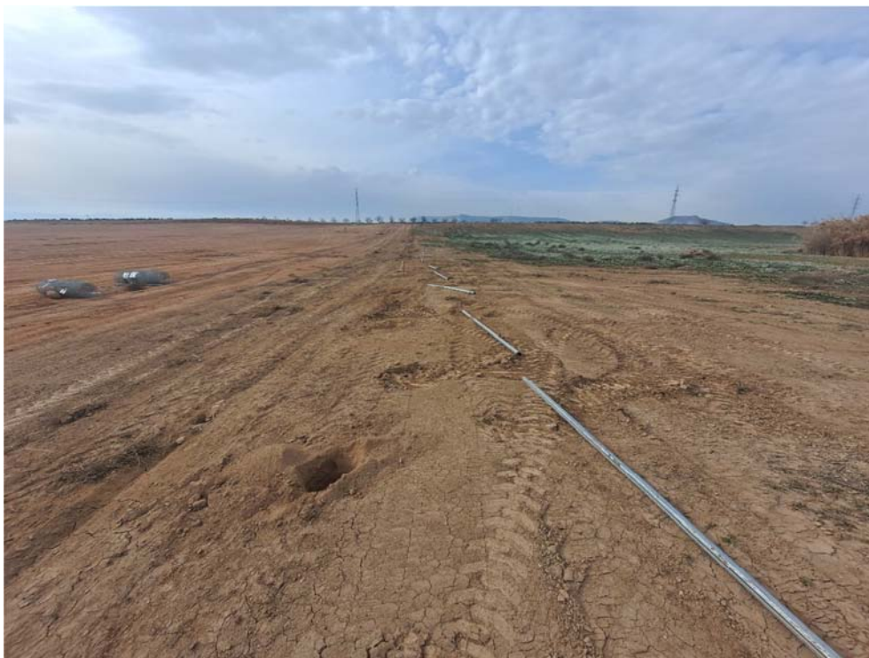
Figura 8.5. Trabajos de reposición del vallado deteriorado, a fecha 15-02-24. Límite noroeste de la parcela
