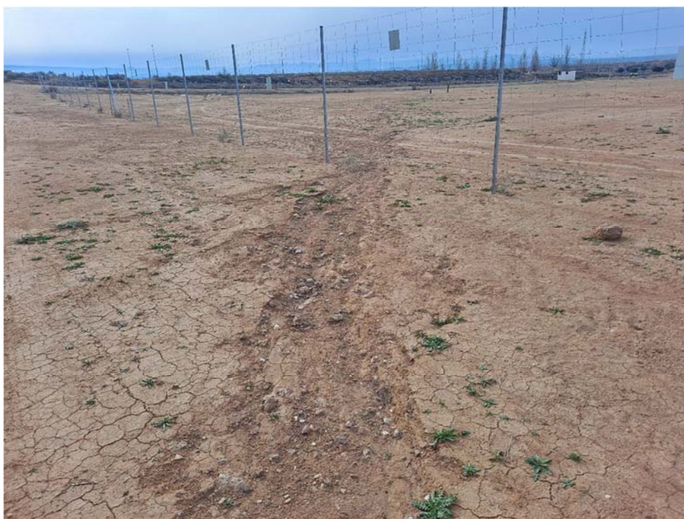
Figura 8.11. Reguero situado en la esquina suroccidental de la parcela, con signos de humedad
