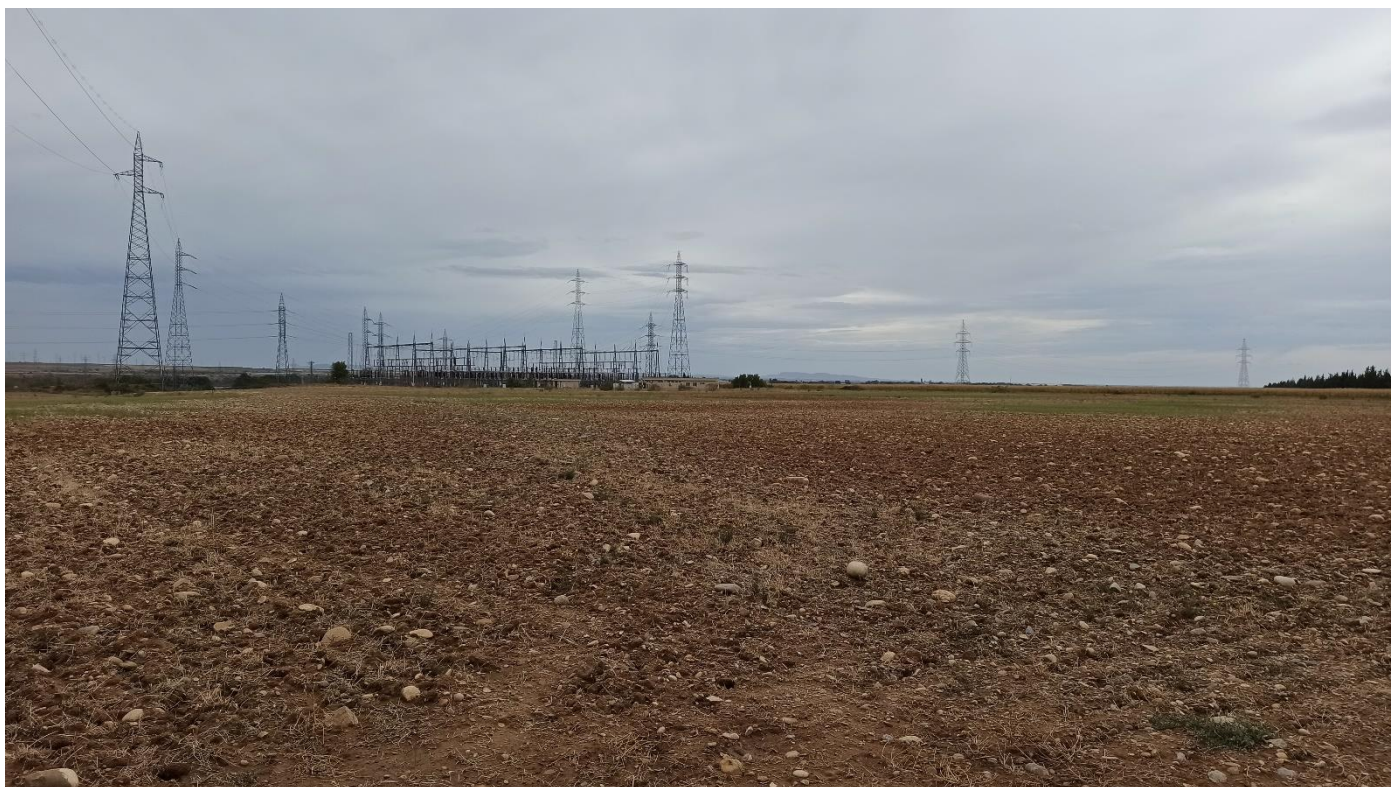
Fotografía 7. Línea de evacuación existente y SET Gurrea REE 220
