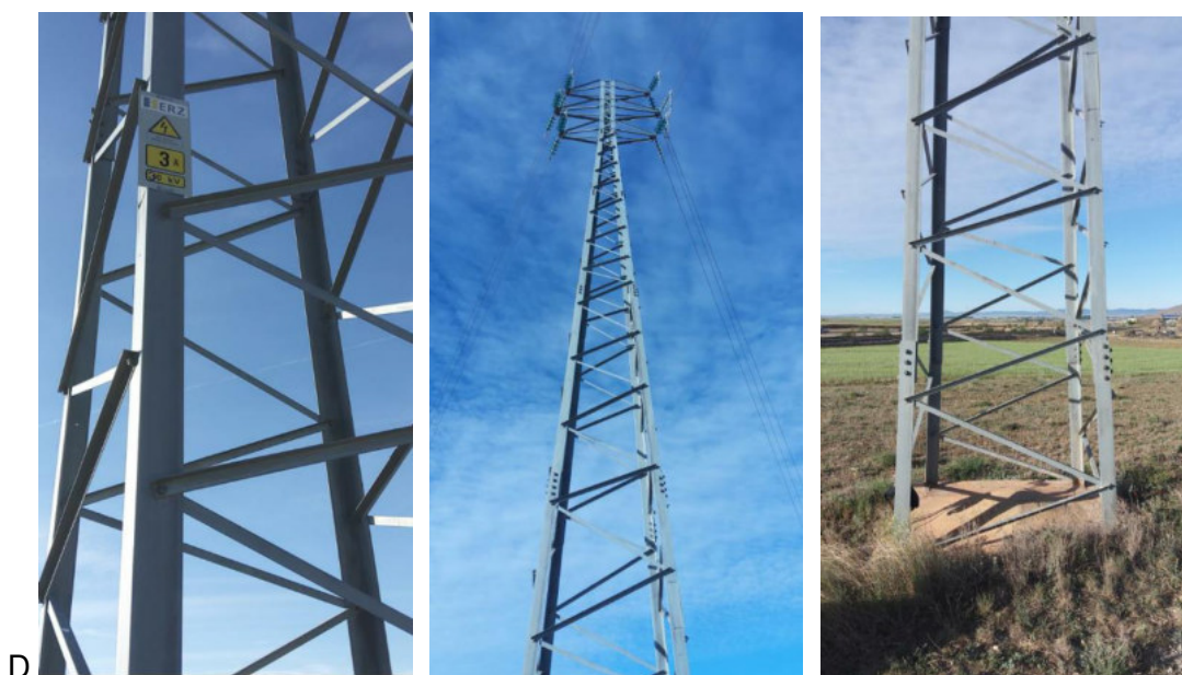
Apoyo 3A existente de la Línea aérea 20 kV CAMINREAL
