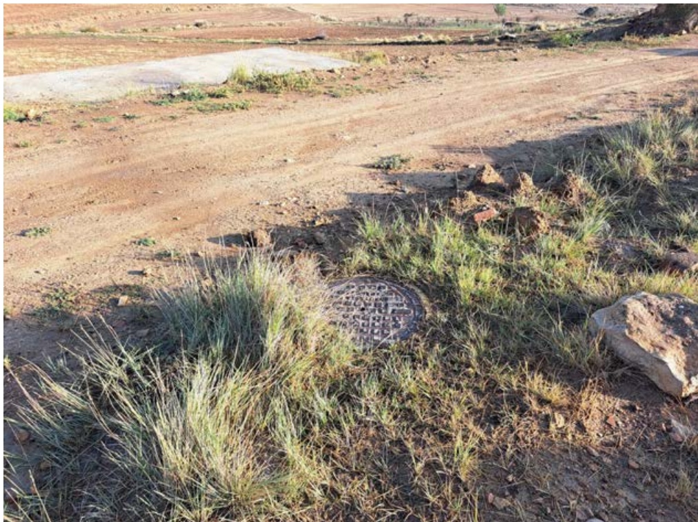
Foto 20. Registro de la tubería de aguas cuyo trazado va sobre el camino de acceso a la explotación.
