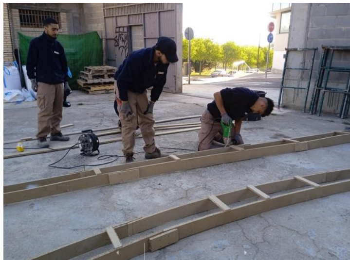
Construcción de encofrados de hormigón para construcción de bordillos de hormigón in situ .
