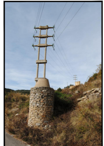
Pozo existente, apoyos y red eléctrica en media tensión.
