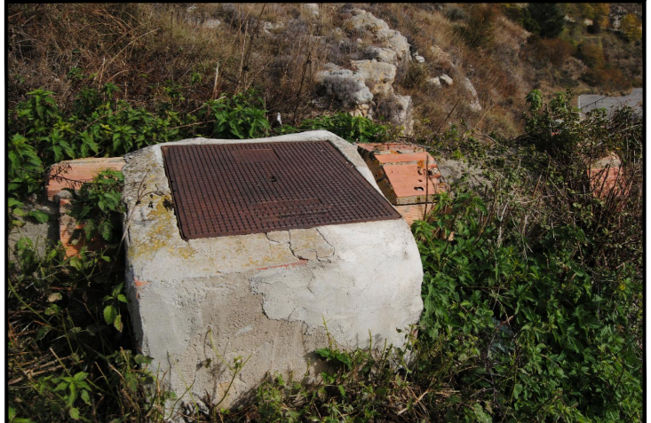
Arqueta existente. Derivación aguas depuradas y conexión con red de riego del campo de golf.
