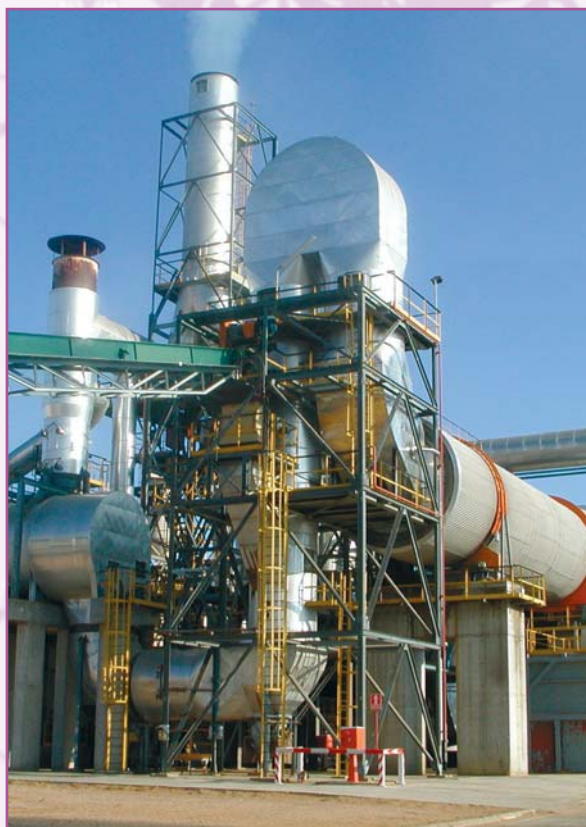
Central de cogeneración de ciclo combinado de FINSA (Cella, Teruel)
