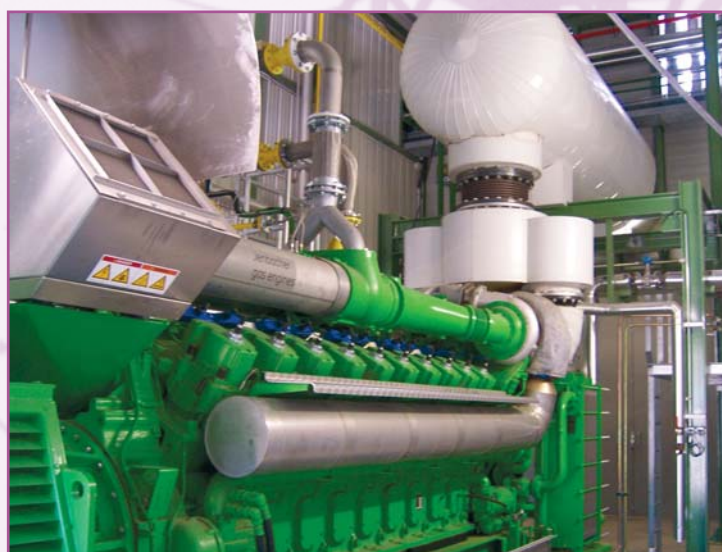
Motores Planta de cogeneración de biogás Saica 2 de 7,5 MW (Zaragoza)
