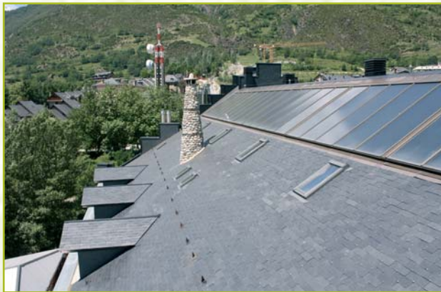
Instalación solar térmica en hotel de 63,61 KW (Benasque, Huesca)
