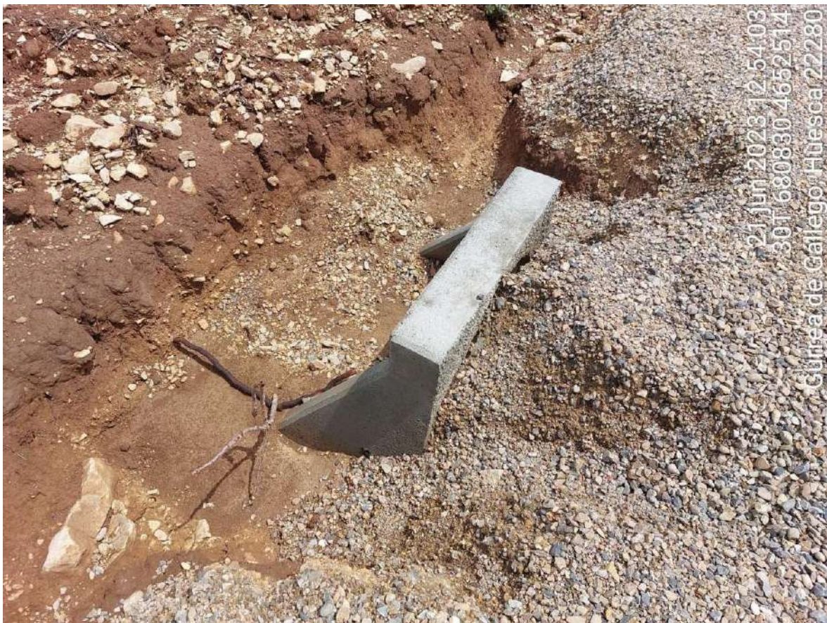
Imagen 2. Desagüe que se debe corregir debido a las lluvias.
