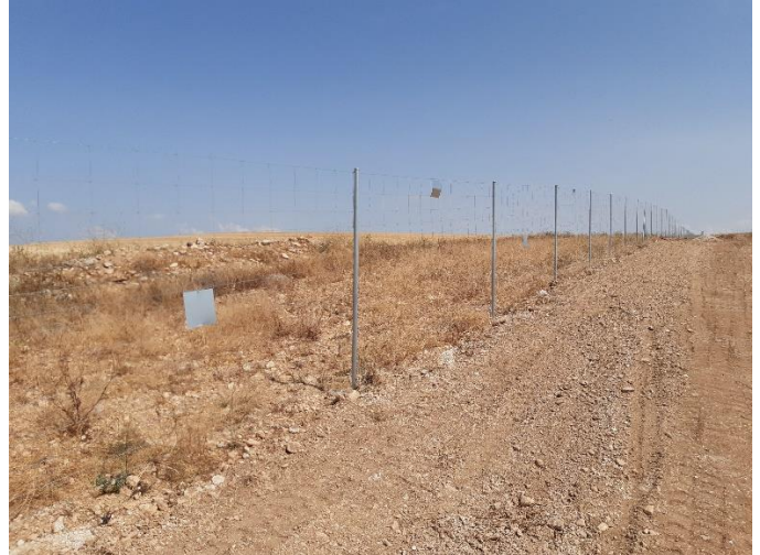
Fig. 3 Disposición de placas metálicas en vallado zona norte
