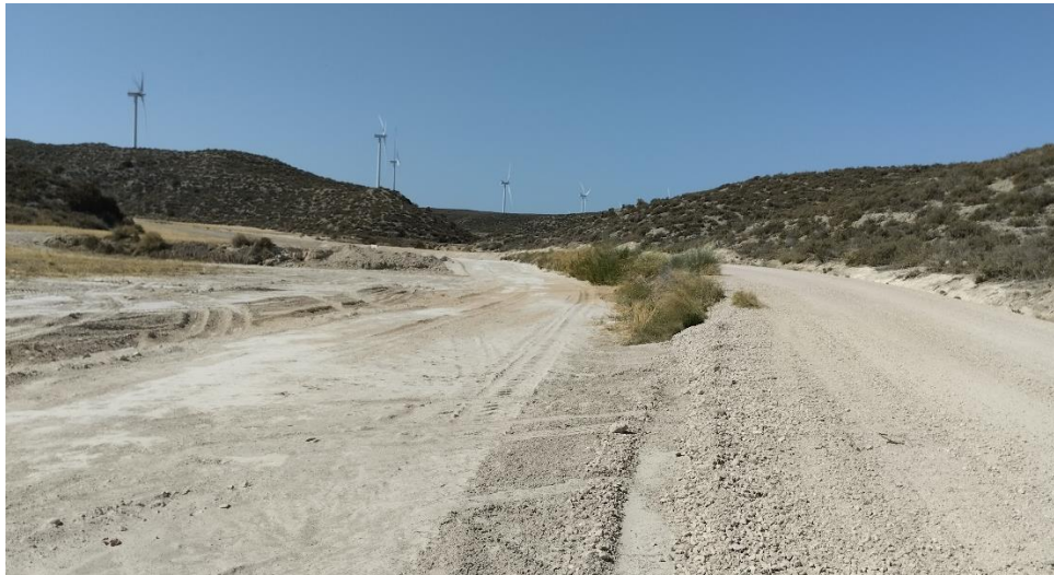
Tramo de zanja de conexión con la SET, sector posterior al cruce bajo el AVE.
