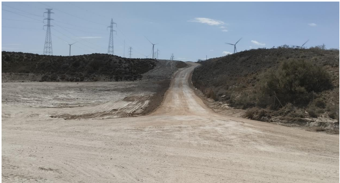
Vial de acceso al sector este del PE, muy afectado por la tormenta, ya reconstruido.
