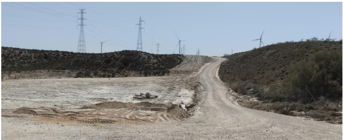
Vial de acceso al sector este del PE, muy afectado por la tormenta, comenzando a repararse.
