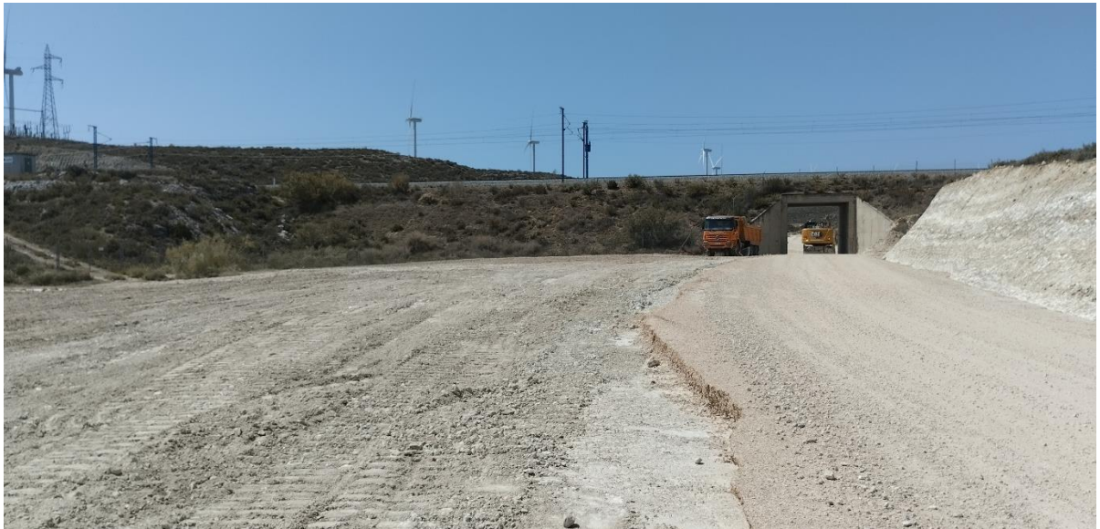
Tramo de zanja de acceso a la SET, sector anterior al cruce bajo el AVE: reparado y restaurado.
