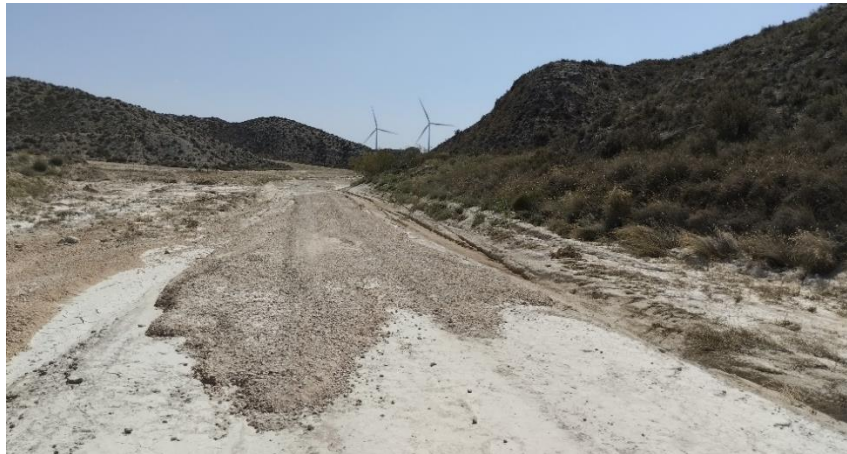
Camino 4, de acceso al ACS 05: en varios puntos, las afecciones a zanjas y caminos han sido muy importantes.
