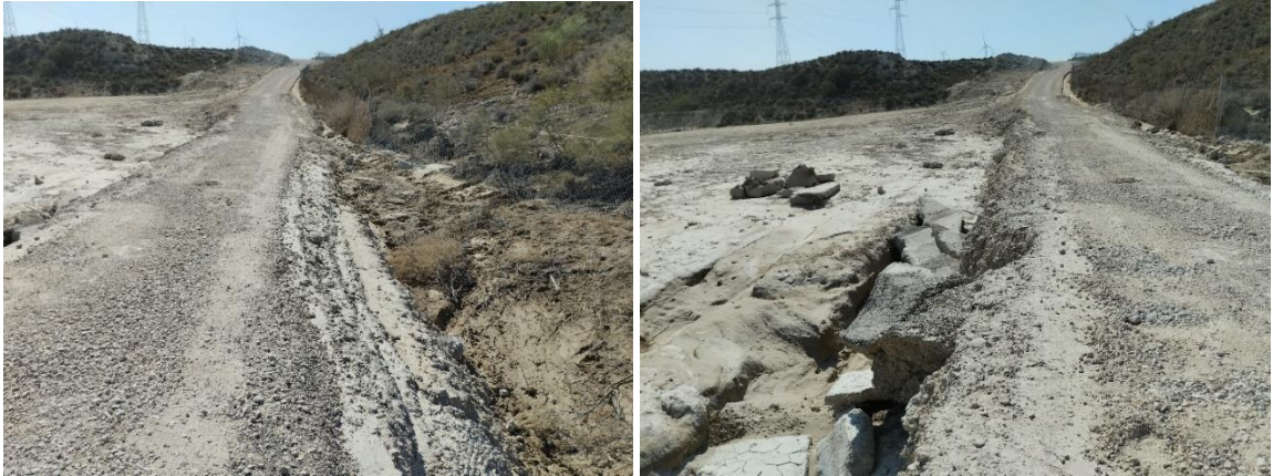
Vial de acceso al sector de los aerogeneradores ACS 03 y ACS 04, en donde las afecciones han sido importantes.
