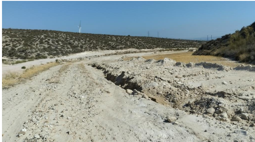
Tramo de zanja de acceso a la SET: sector entre el cruce bajo el AVE y la SET, severamente afectado por la tormenta.
