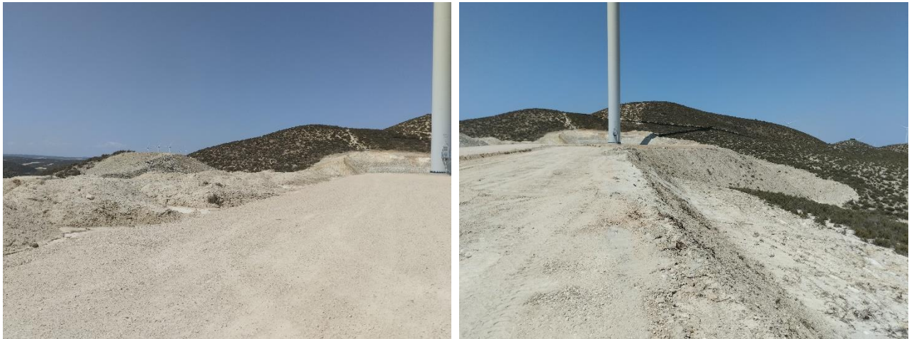
Entorno del aerogenerador ACS 05, en fase de restauración. La plataforma auxiliar que se observa a la derecha será desmantelada y restaurada, como prolongación del terraplén.
