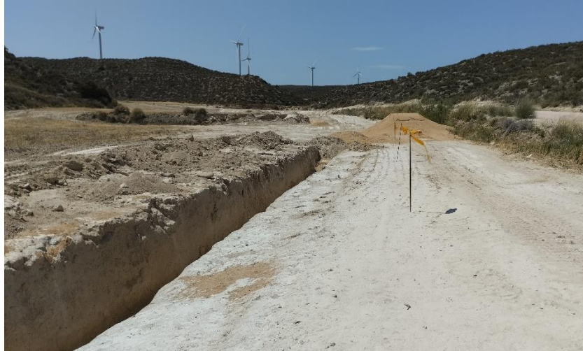
Tramo de zanja de acceso a la SET, tras el cruce bajo el AVE: en proceso las reparaciones y pendiente la restauración.
