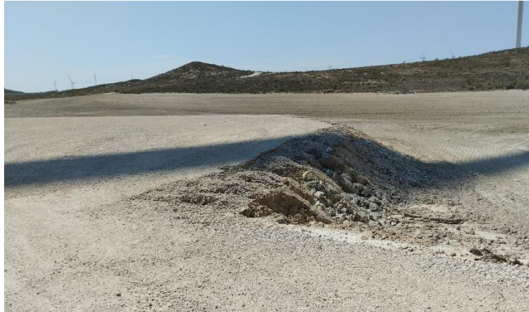
Detalle del terraplén de la plataforma y entorno del ACS 03, afectado por la tormenta: pendiente añadir más tierra vegetal.
