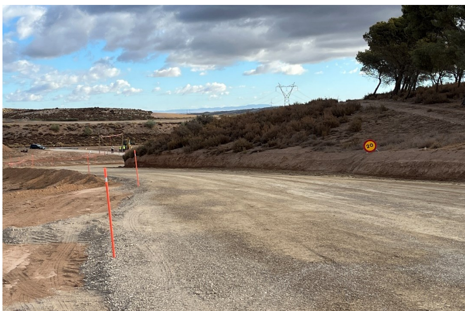
Figura 7 Viales de entrada y señalización de velocidad
