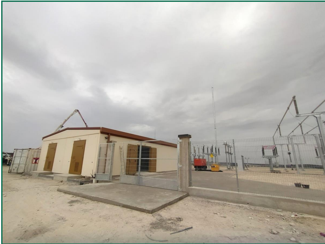
Fotografía 4. Vallado definitivo de la zona donde se ubica el Centro de transformación.
