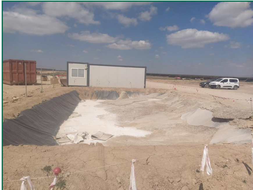
Fotografía 7. Zona de lavado de hormigón.
