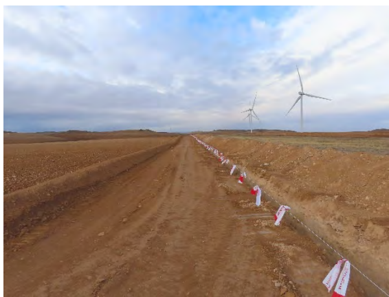
Zanja correctamente abierta con dos cordones de tierras, uno de inertes y otro de suelo fértil, uno a cada lado de la zanja.
