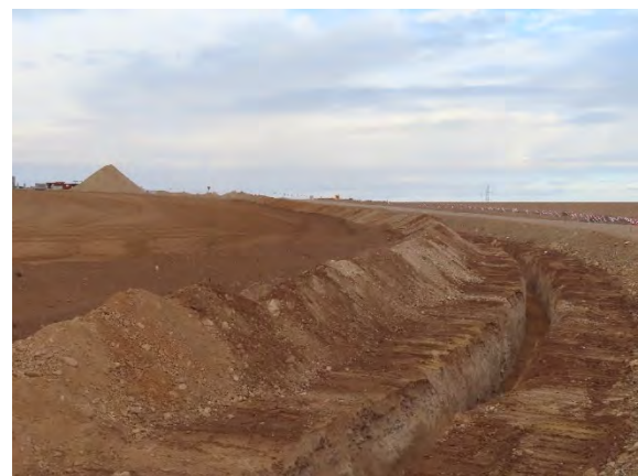
Zanja correctamente abierta con dos cordones de tierras, uno de inertes y otro de suelo fértil, al mismo lado de la zanja.
