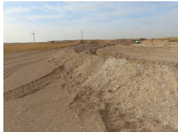
Zanja perimetral de la plataforma REIIA-02 con separación de suelo fértil deficiente.
