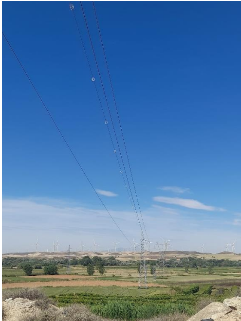
Fig.1. Estado general de balizas salva-pájaros y materiales aislantes.
