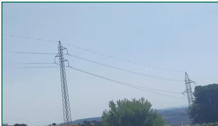
Fotografía 5. Línea eléctrica con balizas salvapájaros
