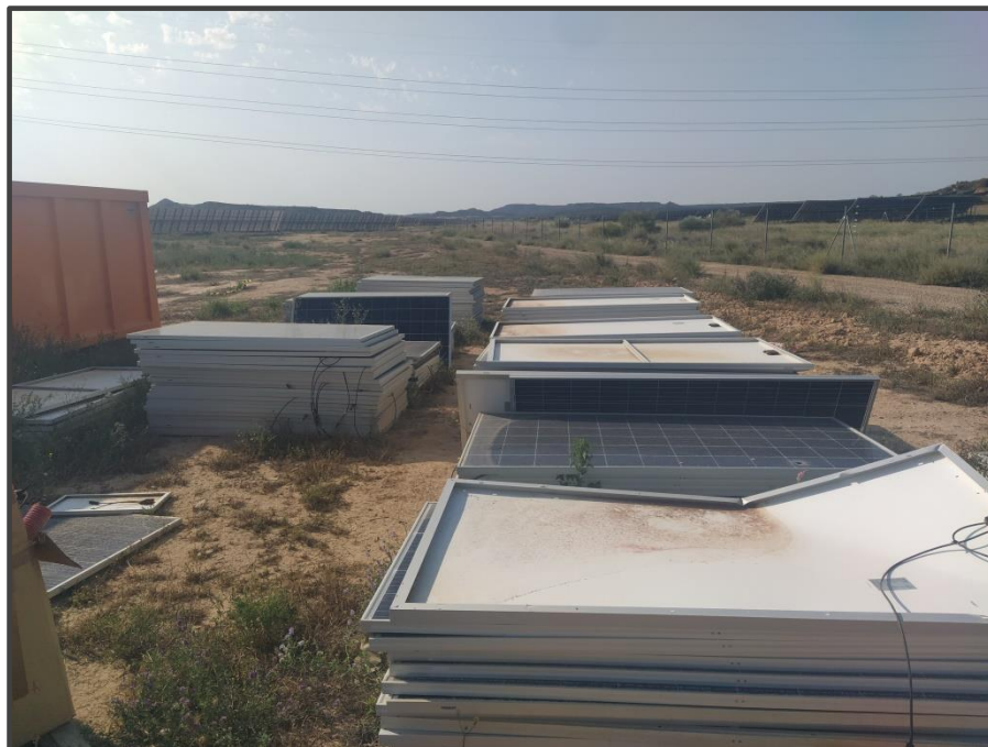
Fotografía 13. Zona de acopio de placas solares deterioradas.
