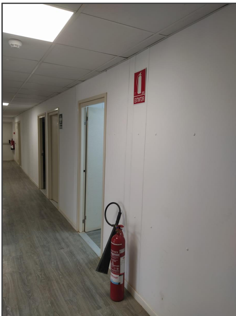
Fotografía 14. Extintores en edificio de control.
