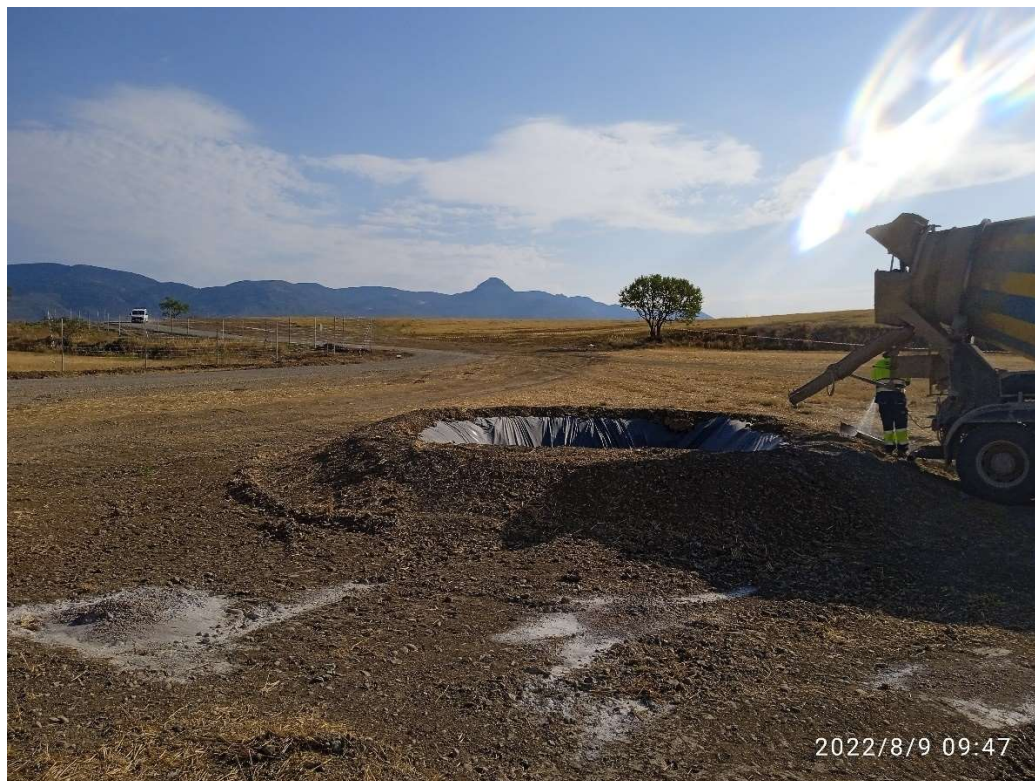
Imagen 17.- Limpieza de hormigonera fuera de la balsa. Se observa que es un procedimiento habitual por los restos de los alrededores.
