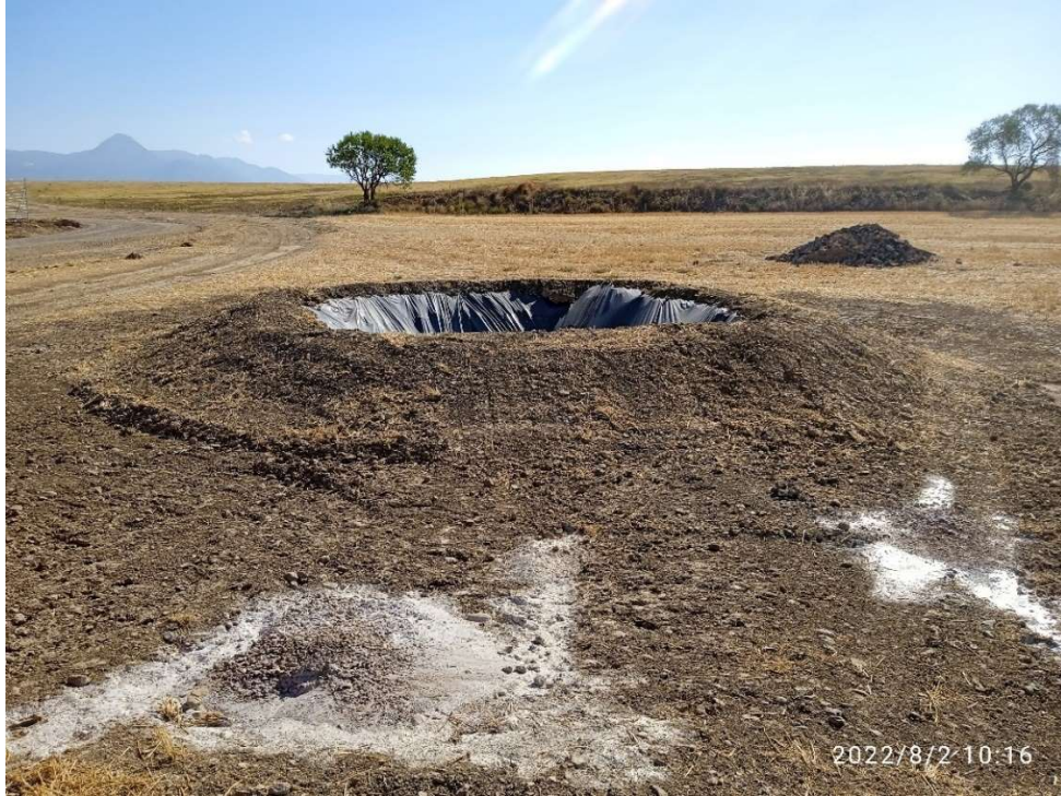
Imagen 9.- Balsa para limpieza de hormigoneras con restos en los alrededores
