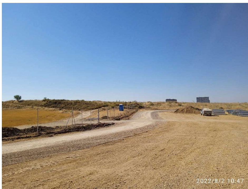
Imagen 2. Acceso Este, con vial perimetral terminado, baño químico y zona de acopio
