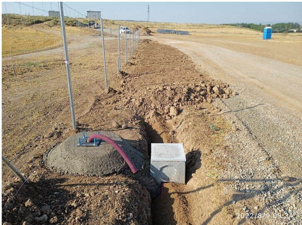
Imagen 6.- Trabajos en instalaciones de seguridad: arqueta, soporte para poste y zanja a medio cubrir.
