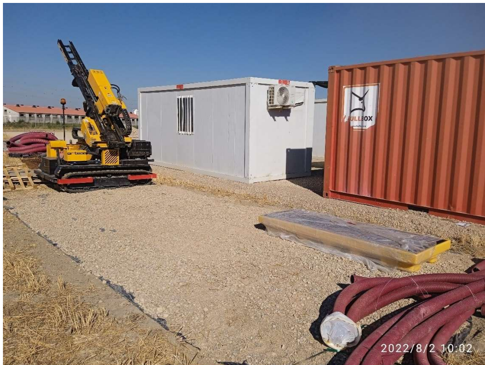
Imagen 10.- Zona habilitada para mantenimiento de maquinaria. Punto limpio de residuos peligrosos en contenedor rojo de la derecha.
