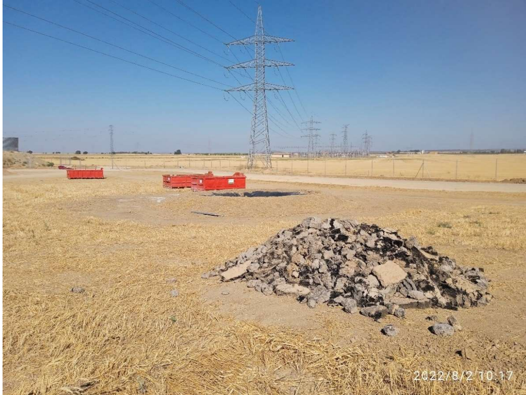
Imagen 7. Punto limpio de residuos no peligrosos y balsa para limpieza de hormigoneras
