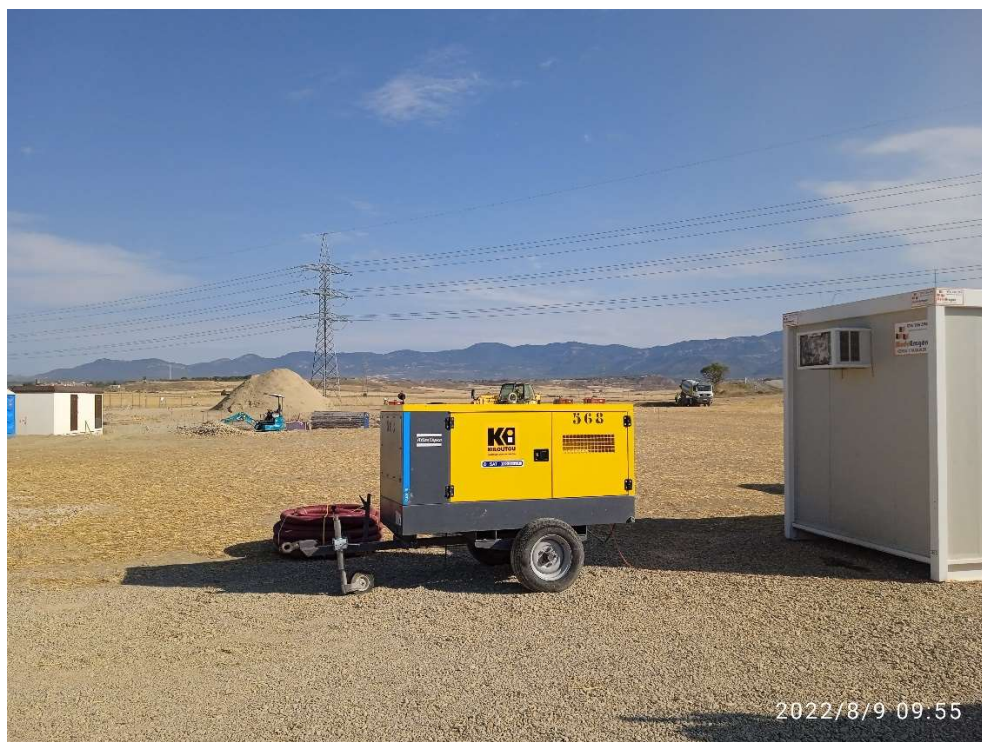
Imagen 10.- Grupo electrógeno anexo en zona de instalaciones auxiliares para abastecimiento eléctrico.
