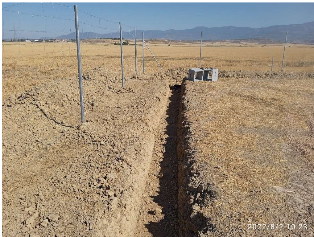
Imagen 4.- Vallado perimetral, con zanja y arquetas para conducciones de seguridad en fase de construcción.
