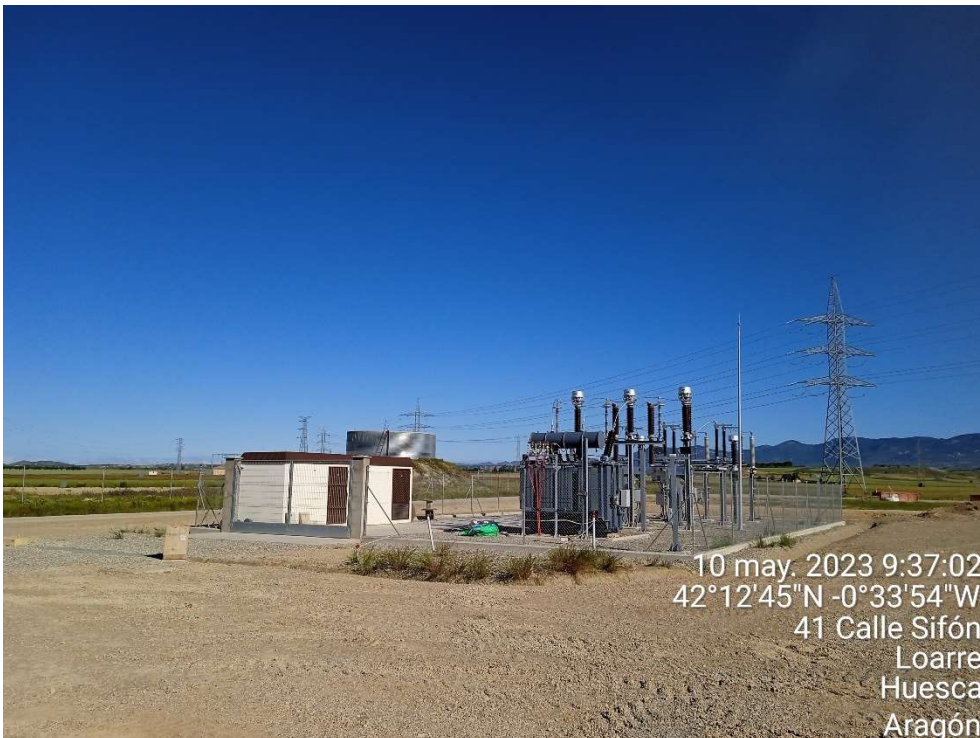
Imagen 6. Subestación de Transformación.
