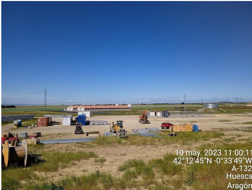
Imagen 5. Zona de instalaciones auxiliares y S.E.T.
