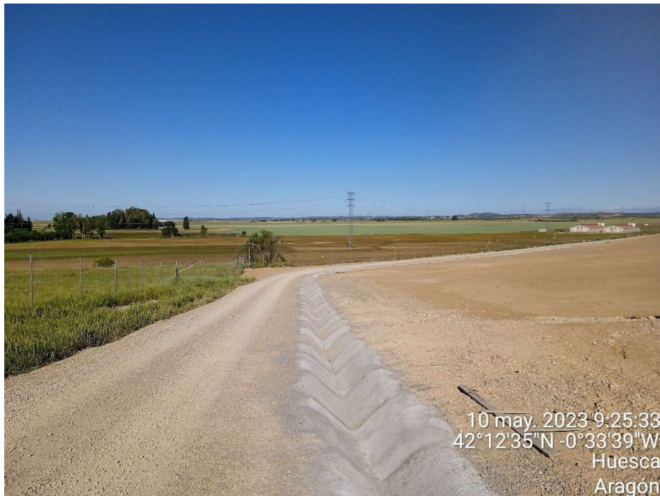
Imagen 12.- Cuneta hormigonada de sección triangular.
