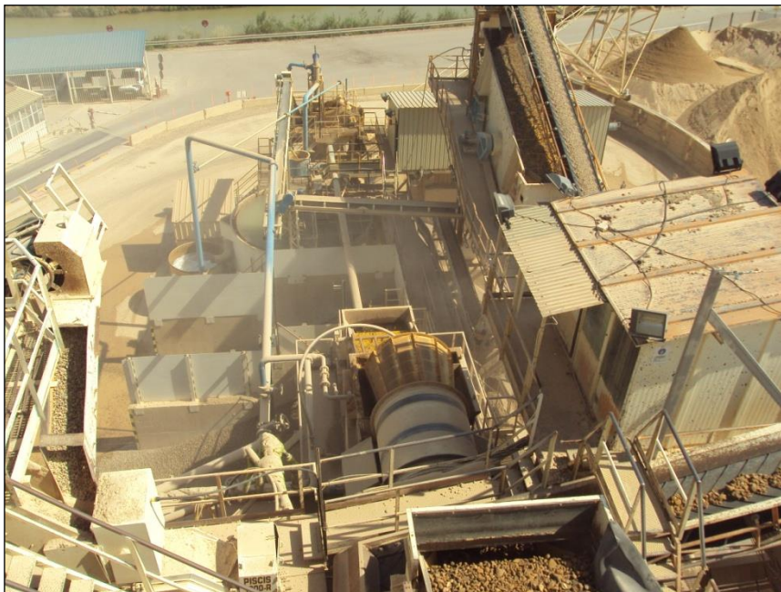
Vista parcial de las instalaciones de tratamiento.
