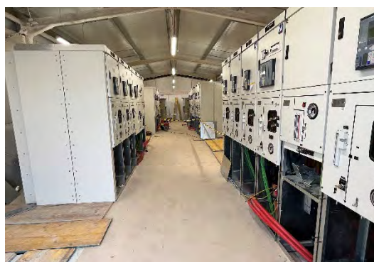
Figura 12 Cableado de los armarios SET
