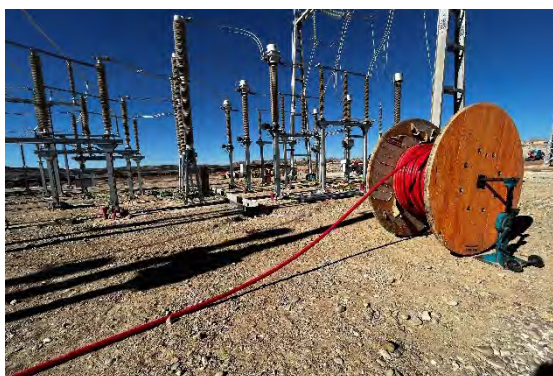
Figura 11 Cableado de la SET
