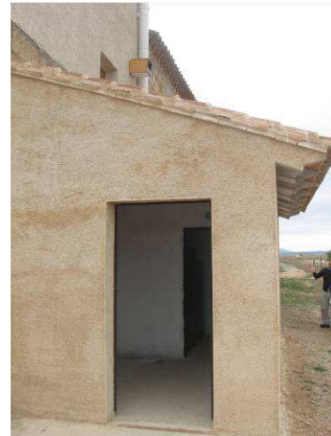
Caseta de calderas
