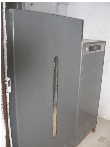
Caldera en el interior de la caseta
