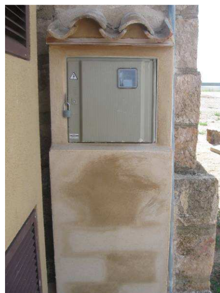
Cuadro eléctrico del Centro de Interpretación
