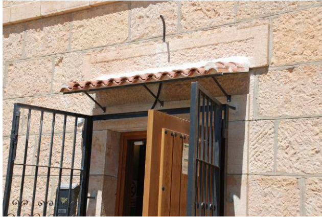
Tejadillo colocado en la puerta del C.I.
