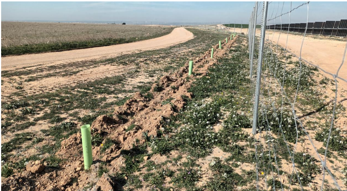
Pantalla vegetal instalada en el perímetro del proyecto.
