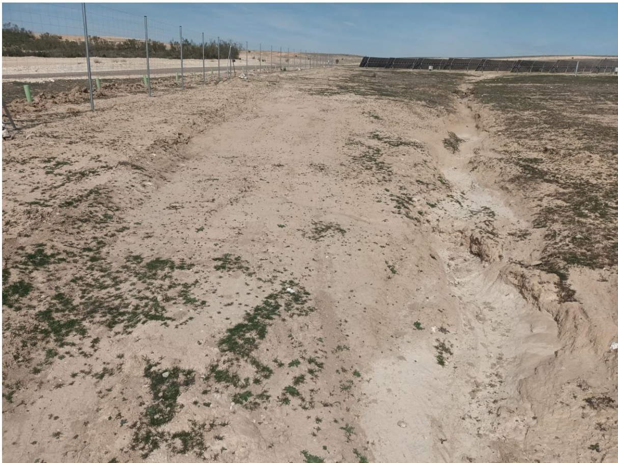
Zona afectada por la erosión.
