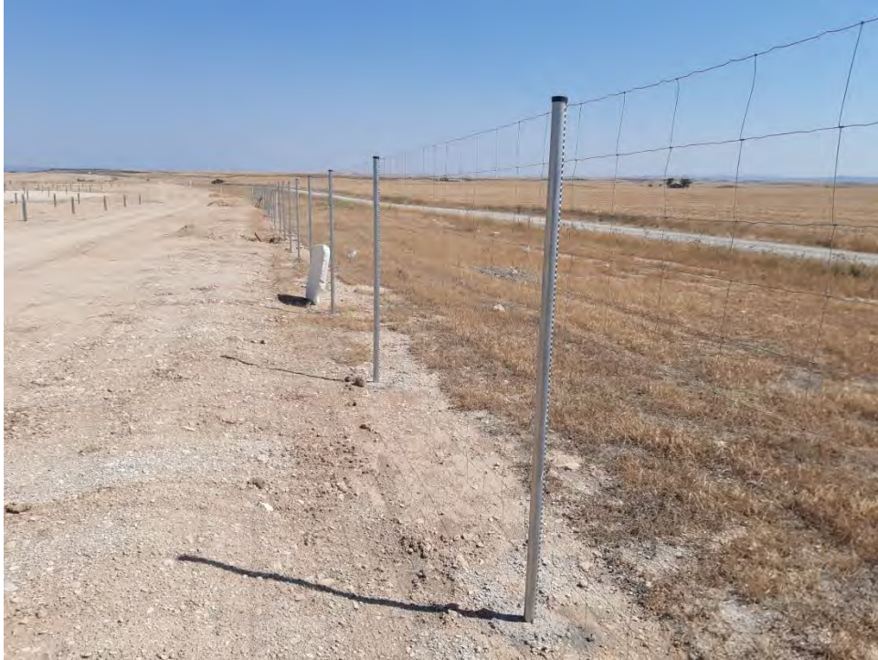
Fig. 2 Residuos en perímetro del vallado
