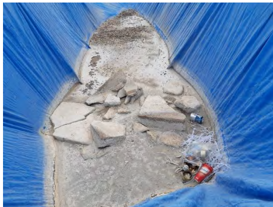
Fig. 2 Residuos dentro de la zona de lavado de canaletas
