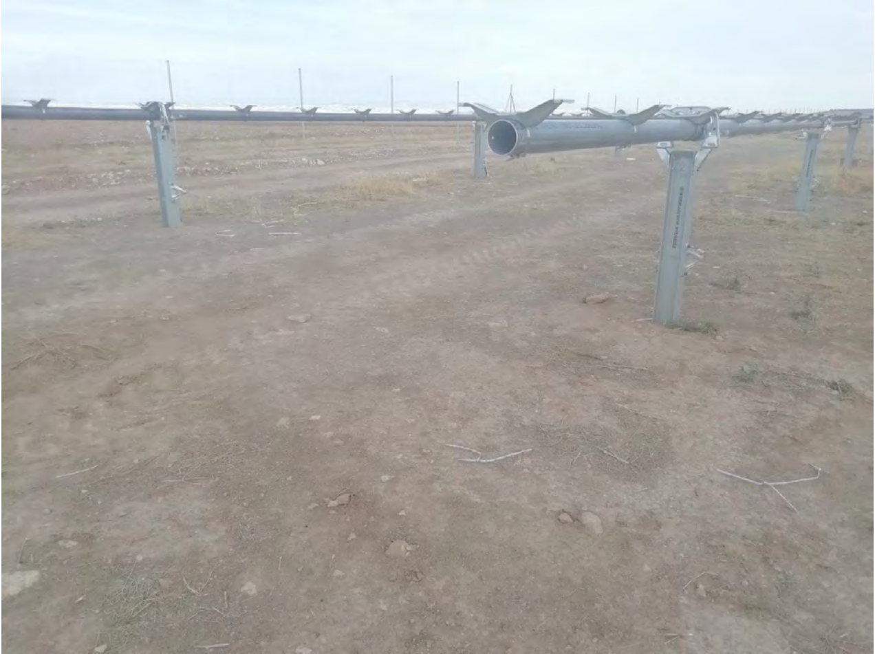
Fig. 2 Restos de plásticos en las zonas de montaje de placas.
