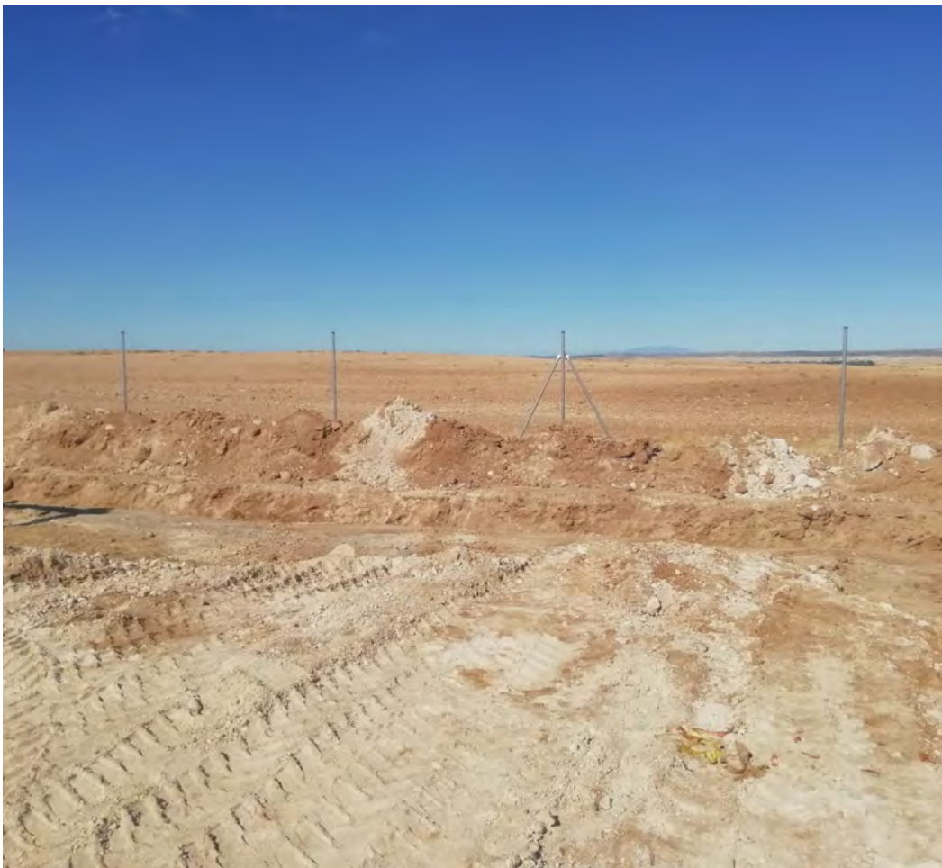
Fig. 1 Tierras extraídas de la zanja sin separación de tierra vegetal.
