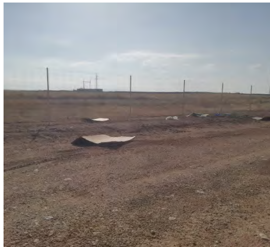
Fig. 2 Restos de cartón y madera en interior de la planta
