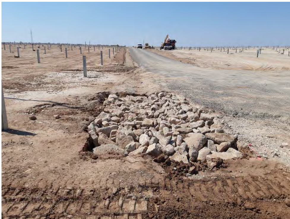
Fig. 1 Escollera instalada al final de cuneta del camino principal de la parcela grande del proyecto.
