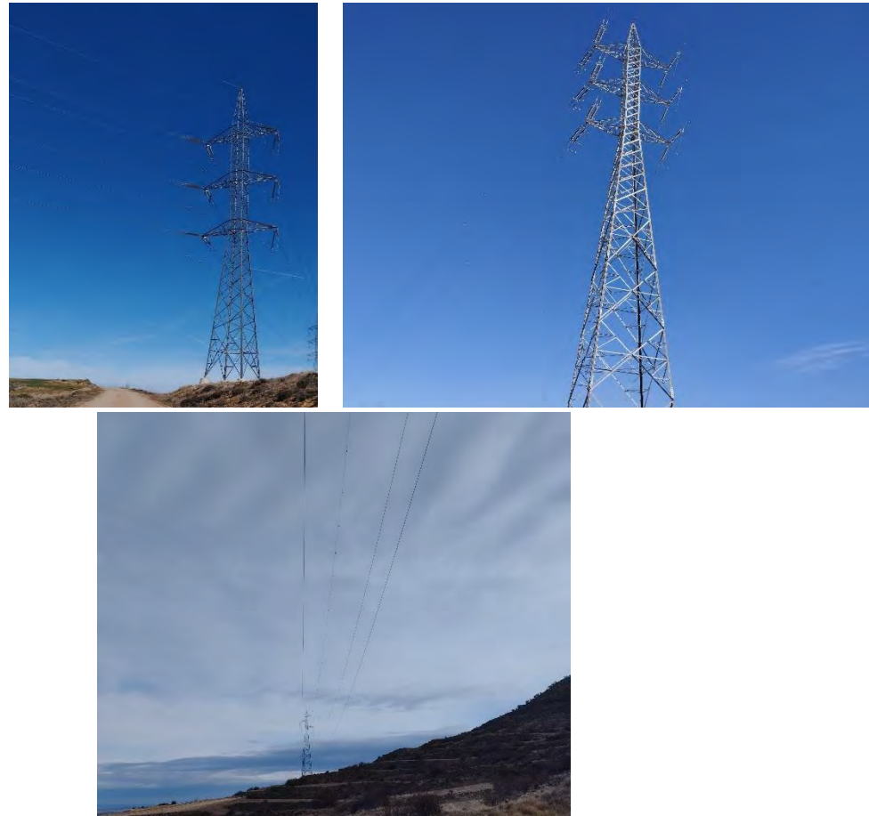
Fotografías 5 a 7: Apoyos de celosía y tendido con salvapájaros
