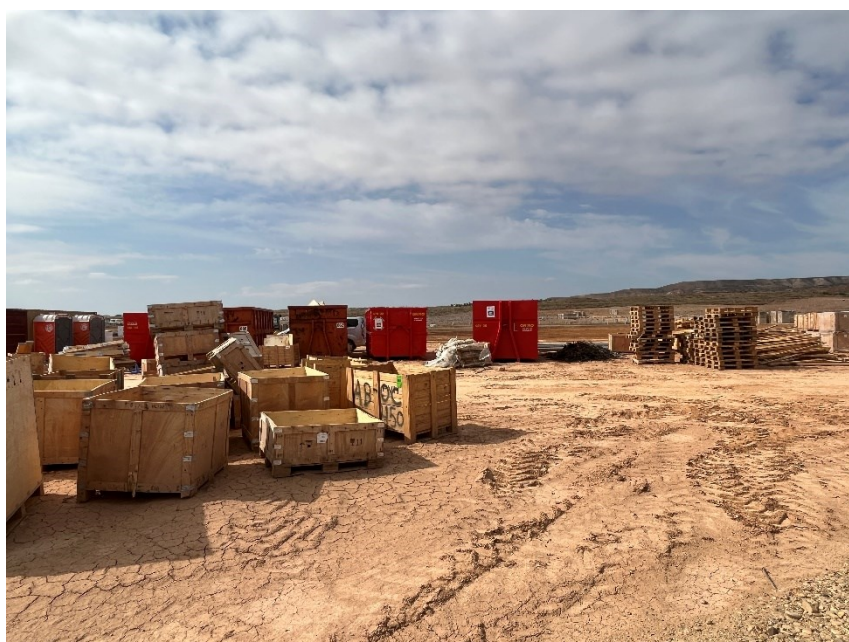
Figura 3 Punto limpio de RNP dispuesto dentro de la planta
