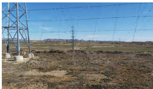
Figura 3: Apoyo 1 y 2 de la línea de evacuación
