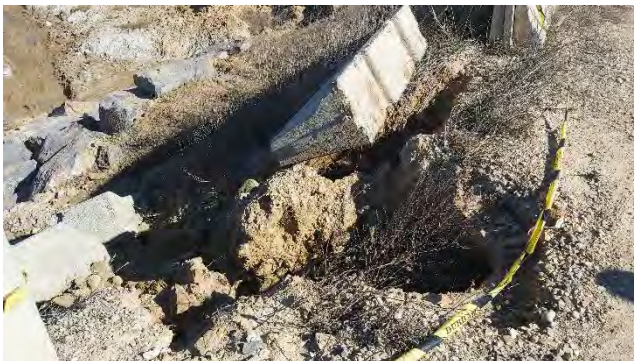
Figura 36: Desprendimiento barrera New Jersey (mala evacuación aguas)
