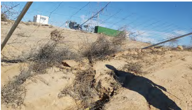
Figura 45: Vallado de la PFV derrumbado (17/02/2022)
