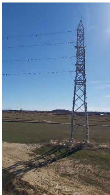
Figura 4: Apoyo 6 de la línea evacuación
