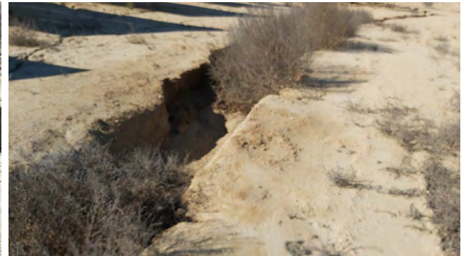
Figura 35: Aumento de anchura de cuneta en tierra
