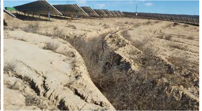
Figura 33: Aumento de anchura de cuneta en tierra
