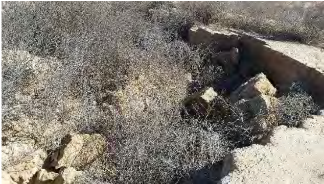
Figura 34: Desprendimiento de cuneta en tierra
