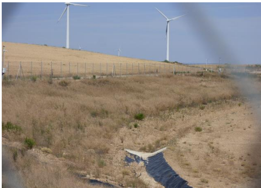
Imagen 2: En los taludes interiores, el resultado de la hidrosiembra es satisfactorio. Se ha desarrollado una cobertura vegetal uniforme por toda la superficie
