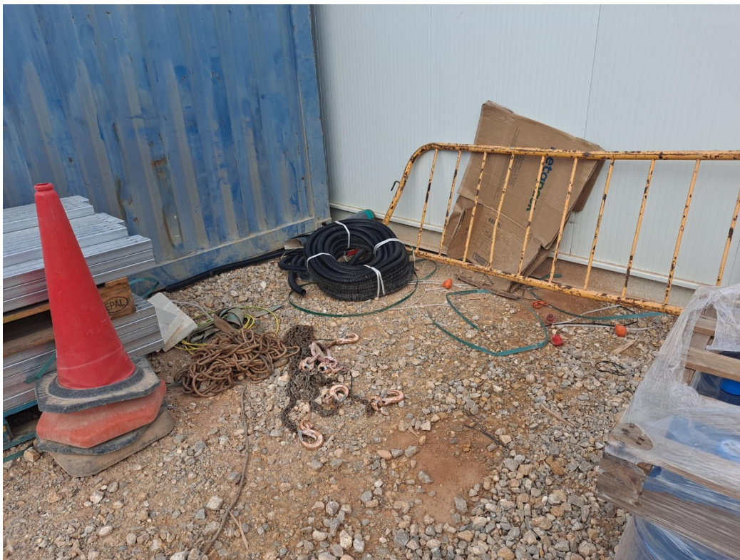
Foto 9. Falta de orden y limpieza
