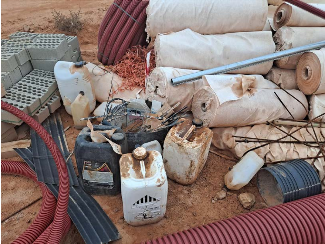
Foto 5. No Conformidad a la empresa subcontratista por almacenar residuos de envases peligroso en obra de forma incorrecta
