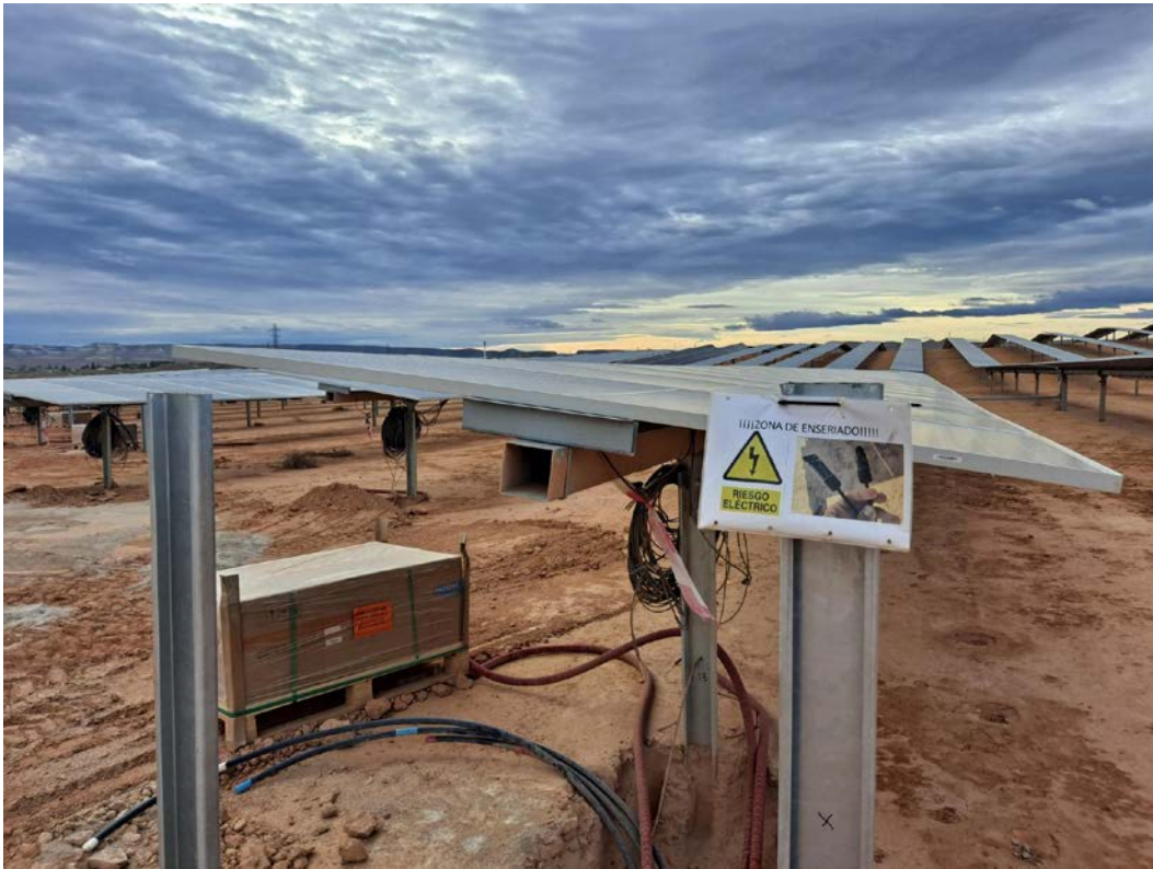
Foto 8. Riegos eléctricos señalizado
