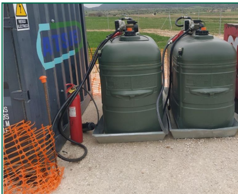
Fotografía 11. Extintor junto a contenedores de combustible.
