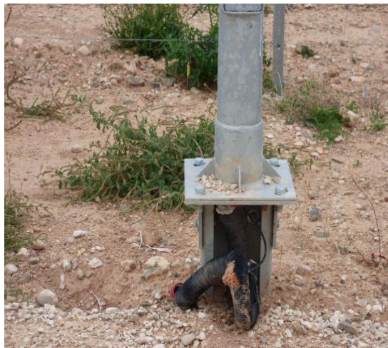
Imagen 14: Cableado en una de las columnas donde se ubica la cámara de vigilancia.
