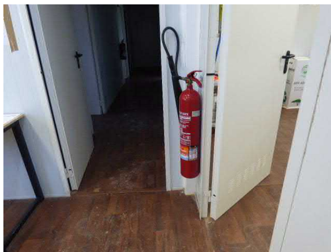
Imagen 25: Foto del extintor disponible en uno de los edificios de O&M.
