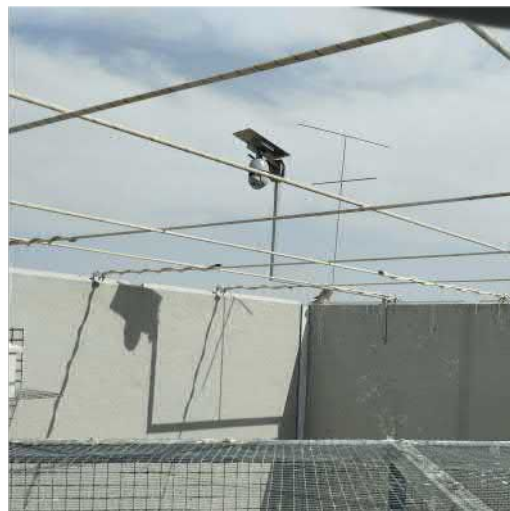
Foto 9: Cámara de video-vigilancia instalada por DEMA en el interior del primillar de Vendimia. Fuente: DEMA, junio 2022.
