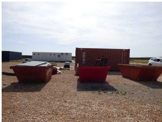
Imagen 22: Contenedores de almacenamiento temporal de residuos no peligrosos.
