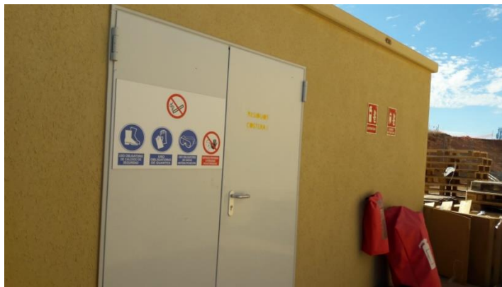
Punto limpio habilitado en la subestación Sierra Costera para el parque eólico de Sierra Costera I.
