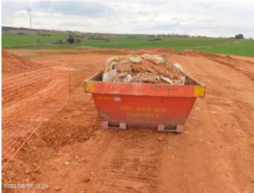
Imagen 3. Contenedores en obra con el residuo de hormigón de las zonas de lavado
