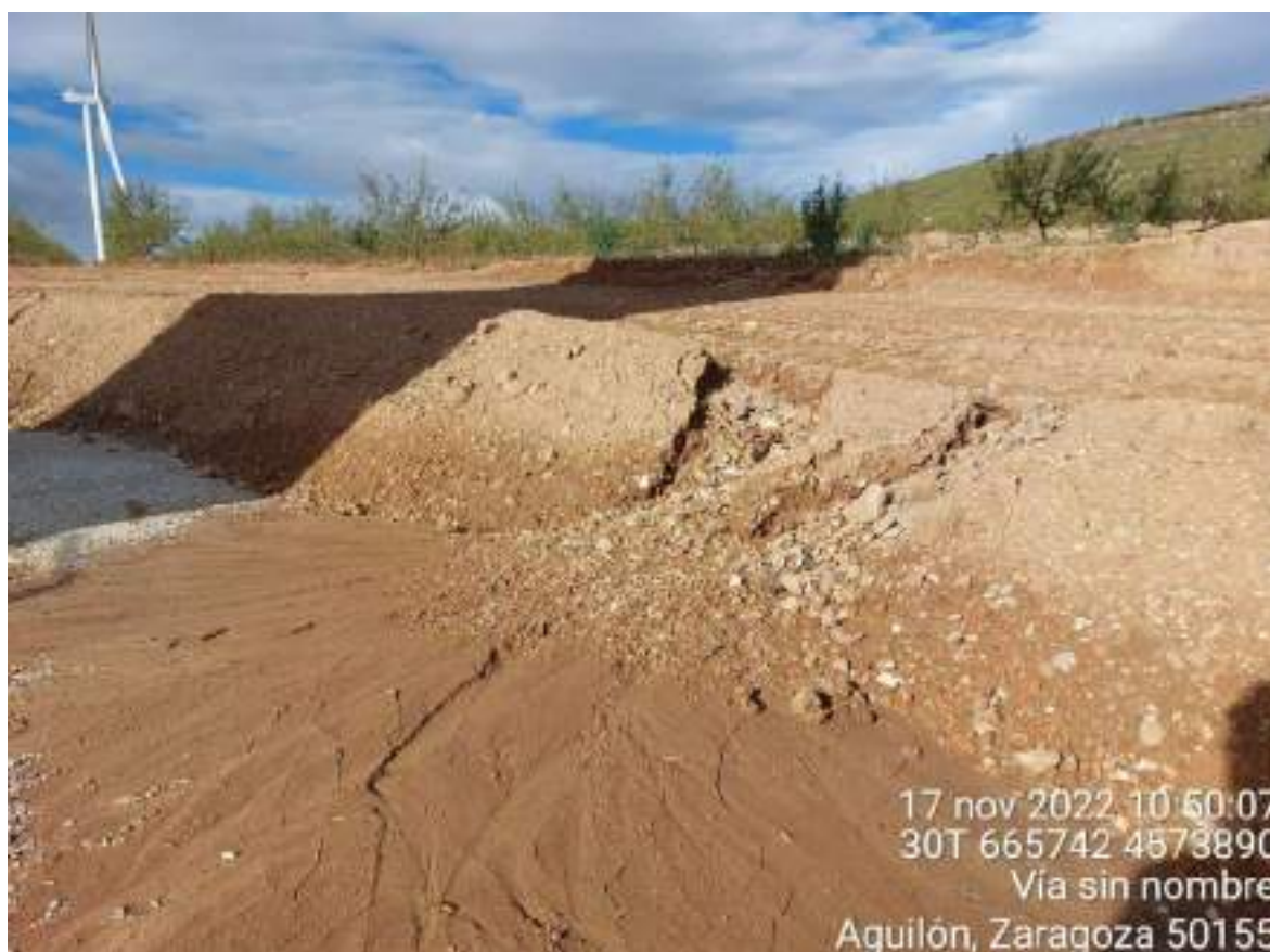
Imagen 1. Cárcavas en SBI-2 tras las lluvias caídas en los últimos días y el talud no estar correctamente fijado.
