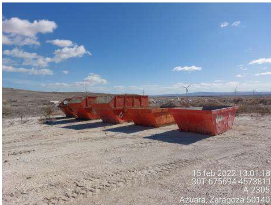
Imagen 6. Punto limpio. Contenedores de residuo no peligroso
