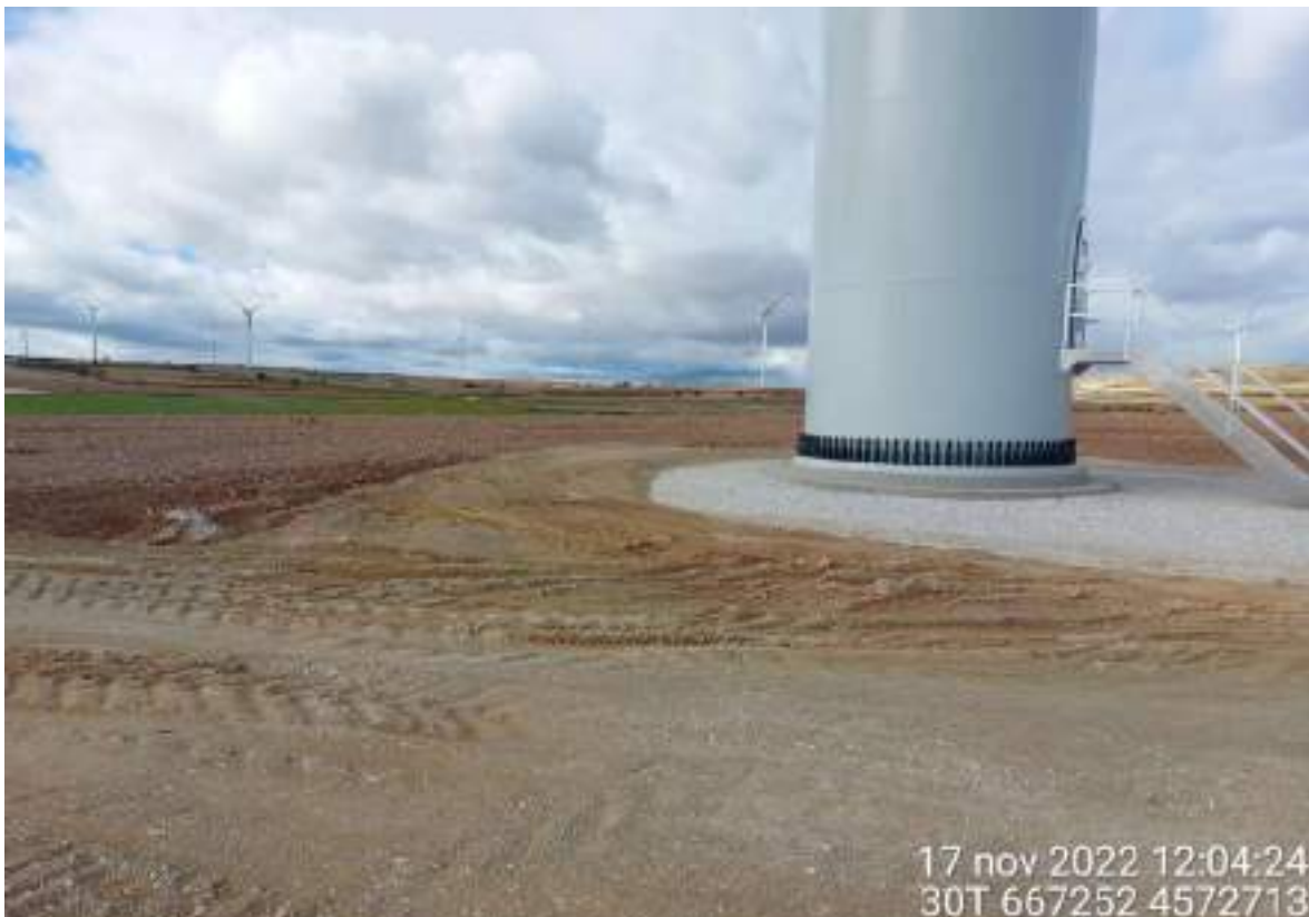
Imagen 3. Plataforma SBI-9 como ejemplo de que falta nivelar y eliminar las roderas existentes en la mayoría de las posiciones.
