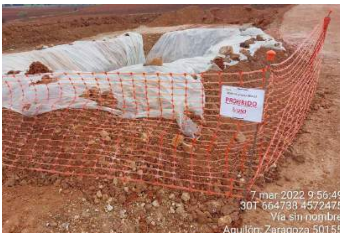
Imagen 2. Zona de lavado con cartel informativo de prohibición de uso.
