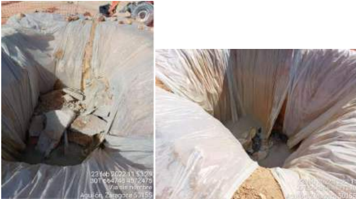
Imagen 1. No conformidad leve. Zonas de lavado con el suelo desprotegido en SBII-02 y SBII-04 con signos de utilización
