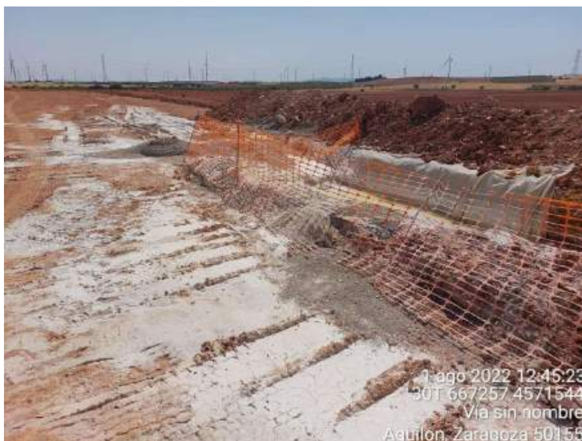
Imagen 1. No conformidad grave. Pozo de lavado sin impermeabilizar correctamente y suelo contaminado en PLX-1.
