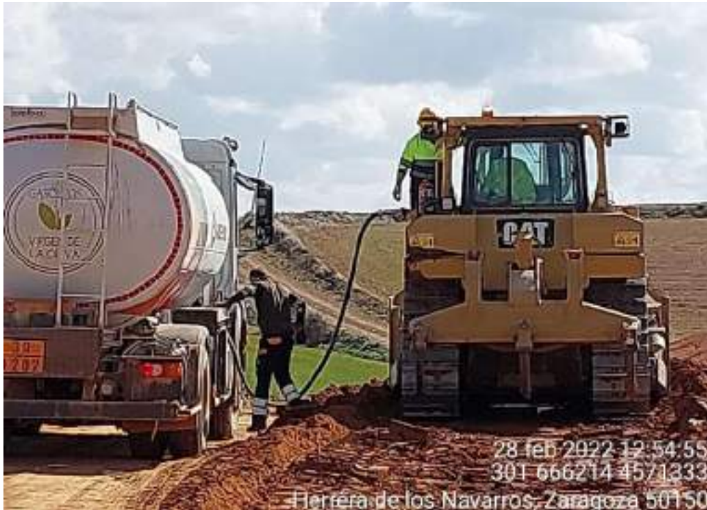
Imagen 3. No conformidad leve. Llenado de depósito de maquinaria sin protección del suelo.
