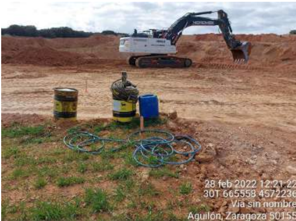
Imagen 2. No conformidad grave. Abandono de bidones sin protección del suelo.
