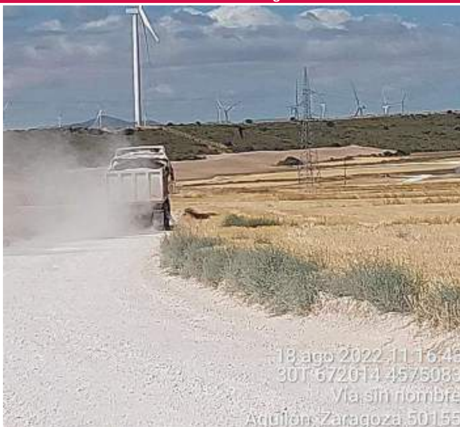
Imagen 1. Bañera sin lona de protección en vial de la obra.
