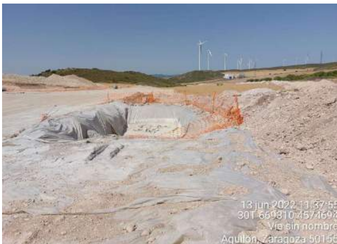
Imagen 1. Pozo de lavado utilizado en hormigonado.
