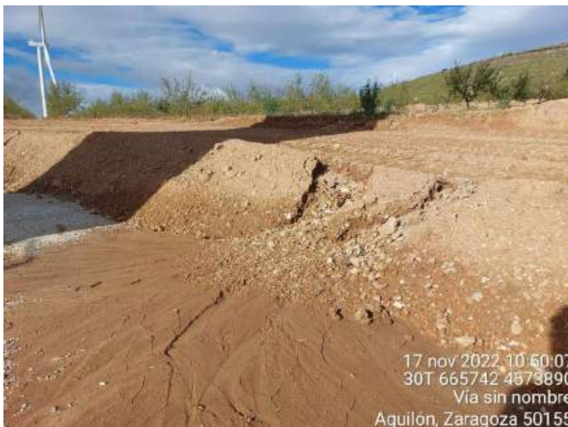
Imagen 1. Cárcavas en SBI-2 tras las lluvias caídas en los últimos días y el talud no estar correctamente fijado.
