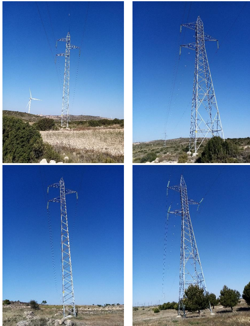
Fotografías 21 a 24: Apoyos de la línea de alta tensión
