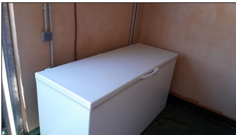
Fotografía 1. Arcón congelador del parque eólico
