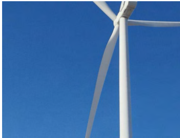
Fotografías 7 a 9: Barquillas de los aerogeneradores sin derrames de aceite
