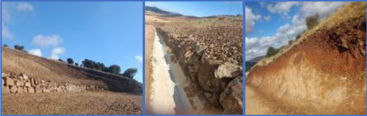
Fotografía 1. Subsanciones de los derrumbes en el parque eólico “El Castillo”
