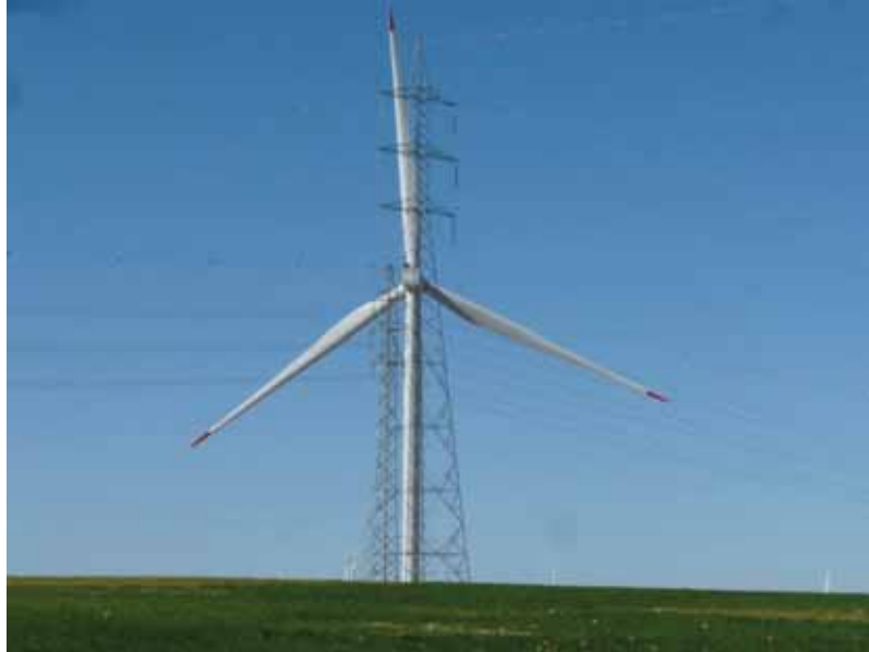
Foto 1. Infraestructuras eléctricas y aerogeneradores. Apoyo 42
