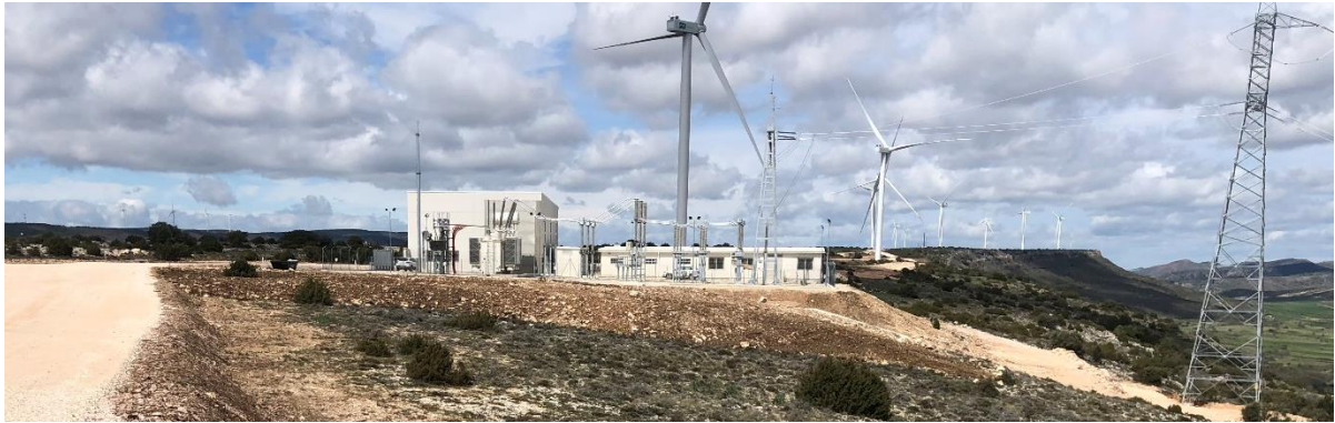
Figura 2: Vistas de la subestación Oriche
