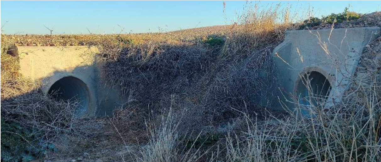
Foto nº25.: Detalle: Drenaje del vial de acceso al PE.
