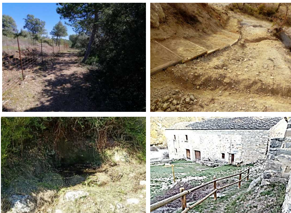
Ilustración 3 Desbroce Parking La Peoner, Escalones S-4, Limpieza fuente Cajigar y colocación vallado S-4
