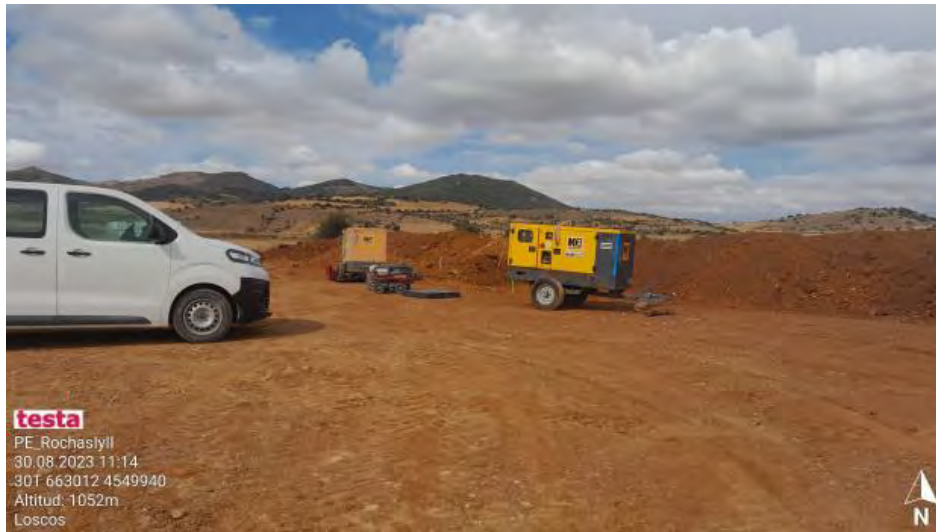
Generadores sin protección en RH1-1
