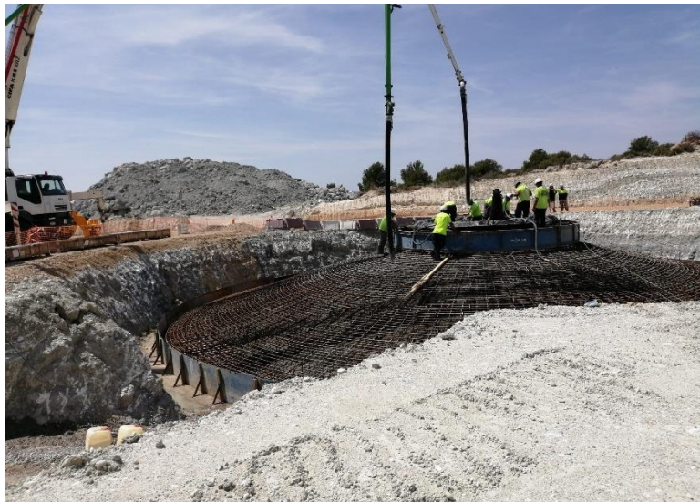
Figura 1: Hormigón de CAM-03.
