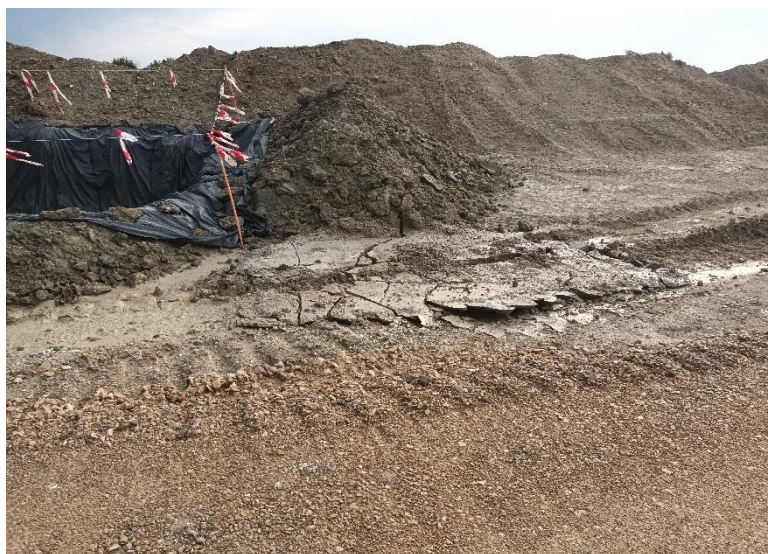
Figura 2: Zona de Lavado de cubas de CAM-02 con un derrame de agua con restos de hormigón.
