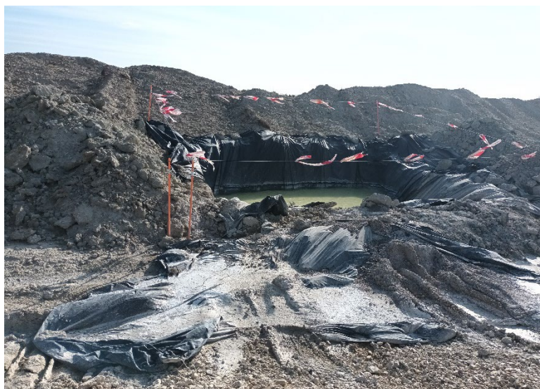
Figura 2: Zona de Lavado de cubas de CAM-02 con un derrame de agua con restos de hormigón.
