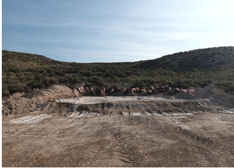
Figura 3: Zona de Lavado de cubas en el vial entre la posición 4 y 3 colmatada de hormigón.
