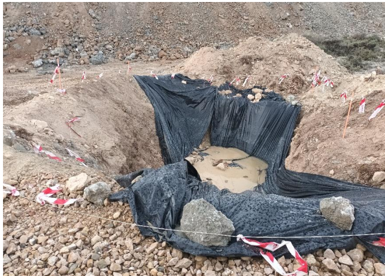
Figura 1: Zona de lavado de cubas de CAM-01 con daños.
