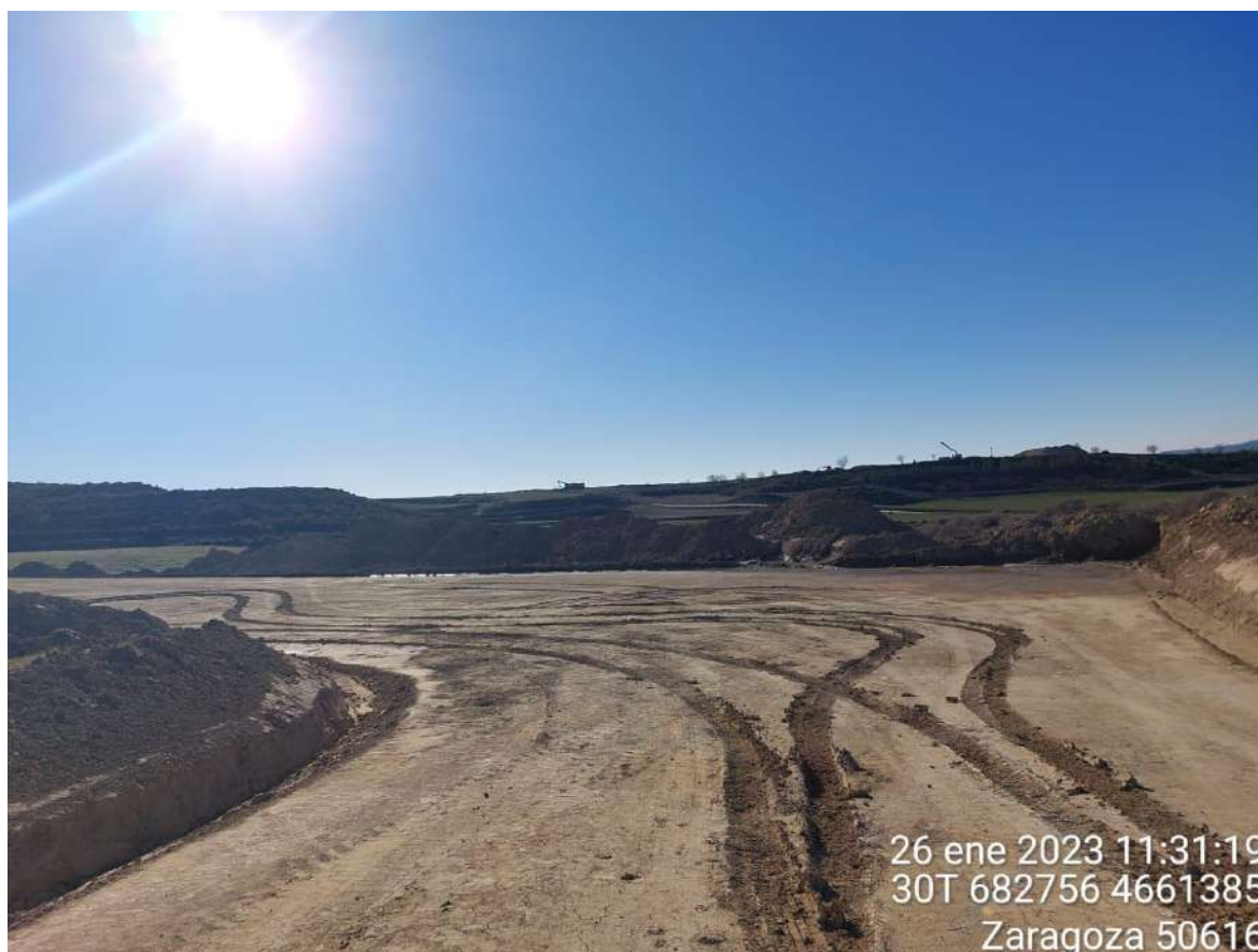
Imagen 1. Zona de la TM de OBIII con el acopio de tierra realizado incorrectamente y caballones por encima de los dos m.
