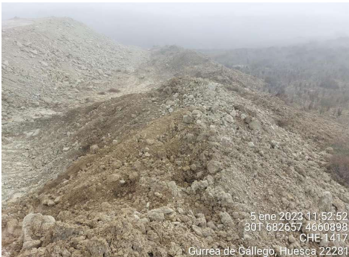
Imagen 2. No conformidad leve. Incorrecta separación de la tierra vegetal del resto del material extraído en OBIII-02.
