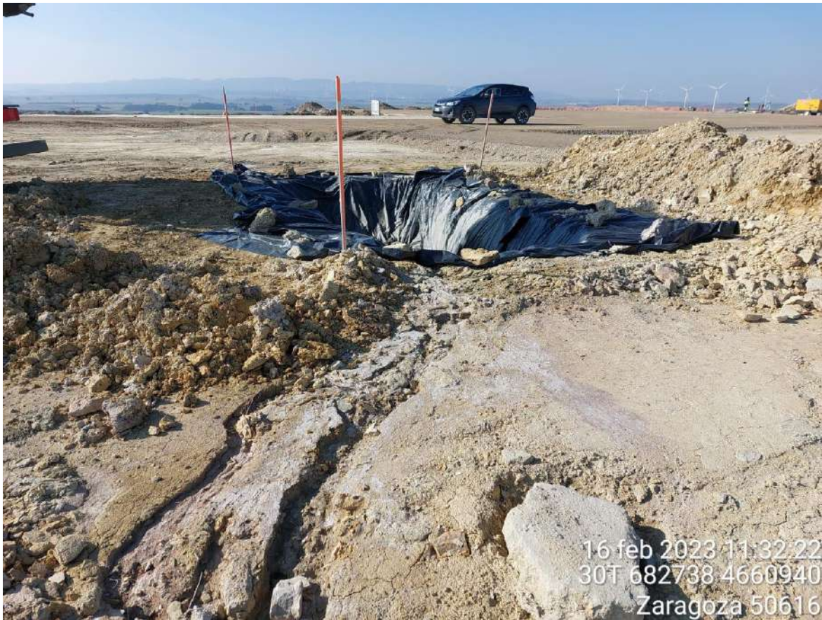
Imagen 4. Escorrentía de agua manchada con hormigón en el pozo de lavado de OBIII-02.
